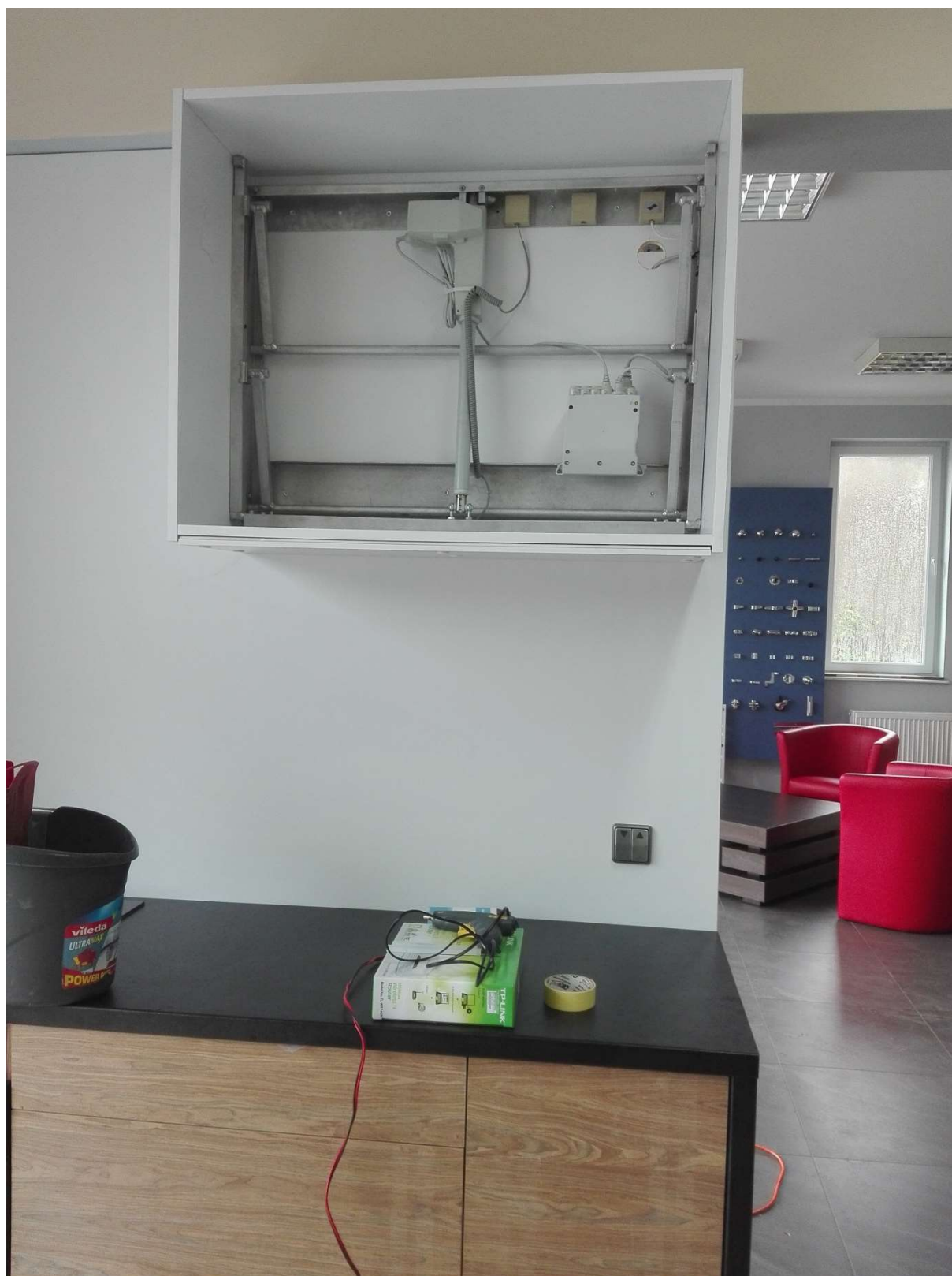
zdj 22. Szafki w pozycji złożonej, widoczny włącznik do sterowania.
